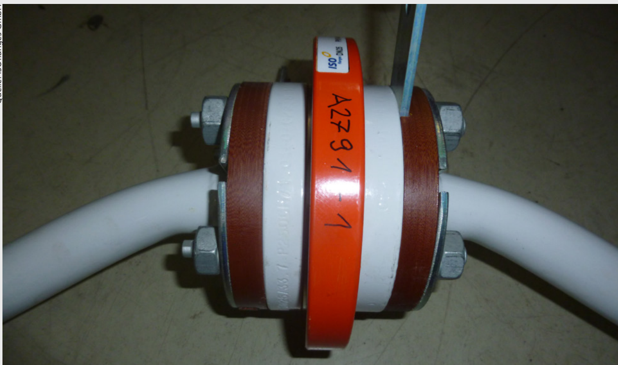
Bild 2: Trotz enormer Biegekräfte, die bei der Leitung zu starken Deformationen führt, ist die Isolierflanschverbindung von der ISOflanges GmbH weiterhin dicht und uneingeschränkt funktionsfähig
